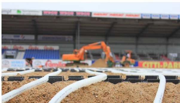
Abbildung 10: Ansicht Heizregister Rasenheizung (heiler GmbH, 2023)
